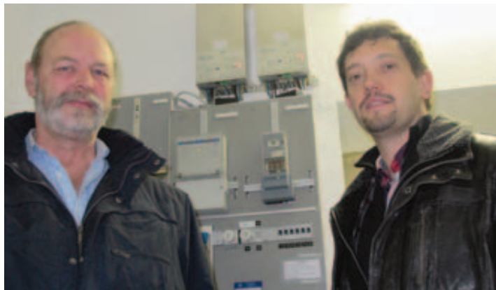
Philippe Allaman et Frédéric Boisset devant les deux variateurs posés dans l'armoire de distribution pour moduler l'intensité lumineuse durant la nuit. LE NOUVELLISTE
